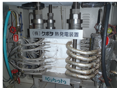
過去に共同開発した焼却炉余熱利用熱電発電器
