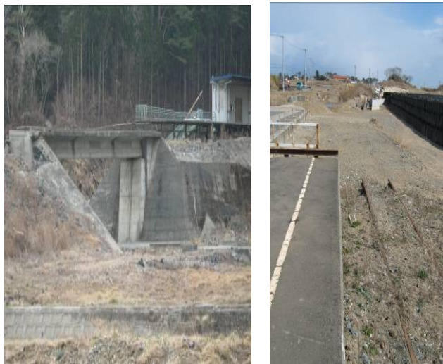
写真 23 切断された線路
